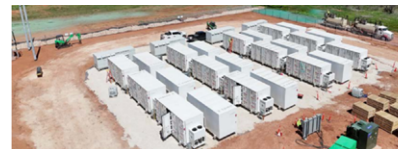
북미 협력회사와 협업을 통해 Texas 지역에 Reuse ESS 시스템 설치 및 운용
